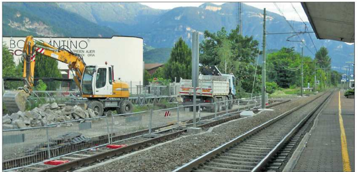
Direkt neben den Geleisen sind am Aurer Bahnhof die Bagger aufgeföhren (links im Bild). Es wird unter anderem die Bahnsteigkante erhöht. deb
