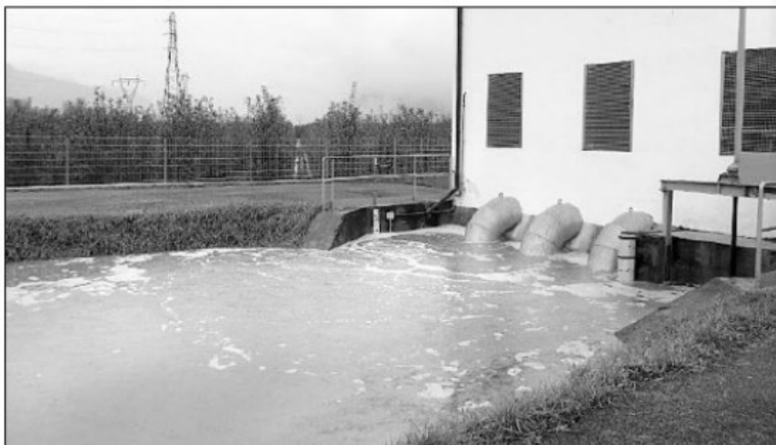
Das Pumpwerk Auer 1 des Bonifizierungskonsortiums Eisackmündung-Gmund stand im Dauereinsatz.
