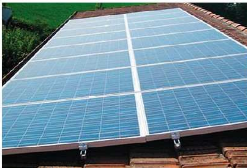
Pannelli fotovoltaici: il Comune di Ora li sfrutta per lo scambio di energia
