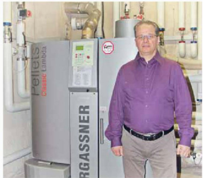
Eduard Abram freut sich über die Einsparung von über 70% der Energiekosten gegenüber der alten Heizölanlage.
