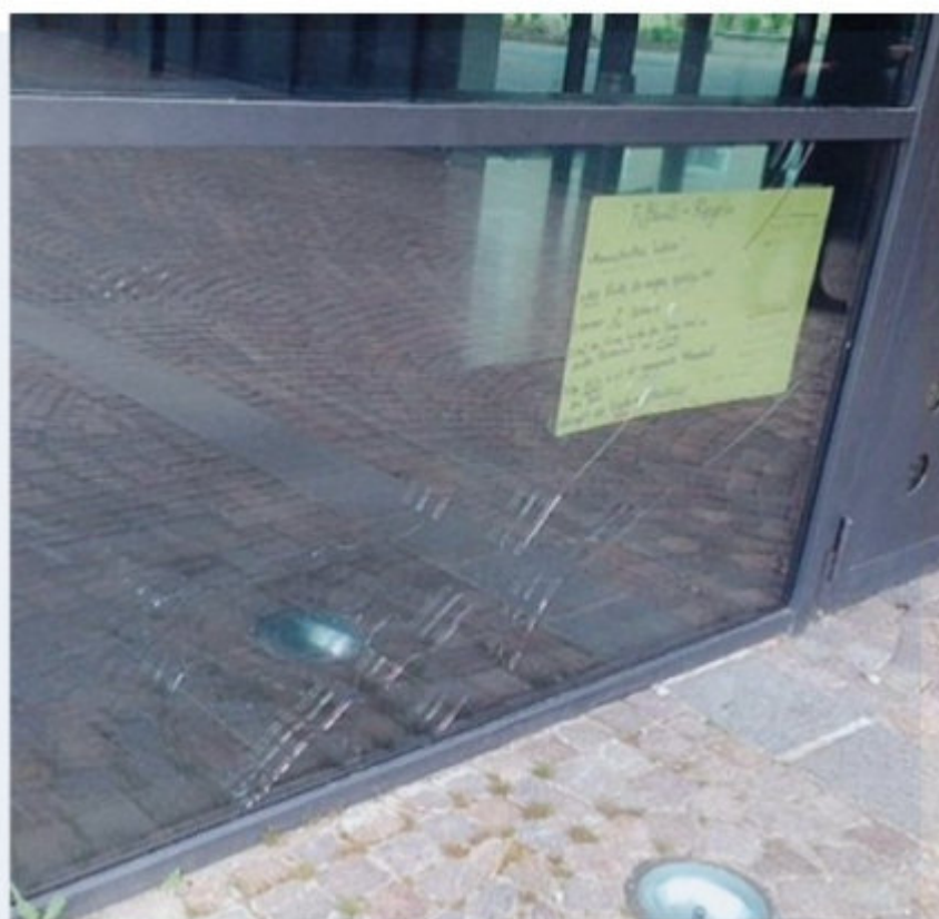
Il lastrone di vetro rotto e non ancora sostituito
