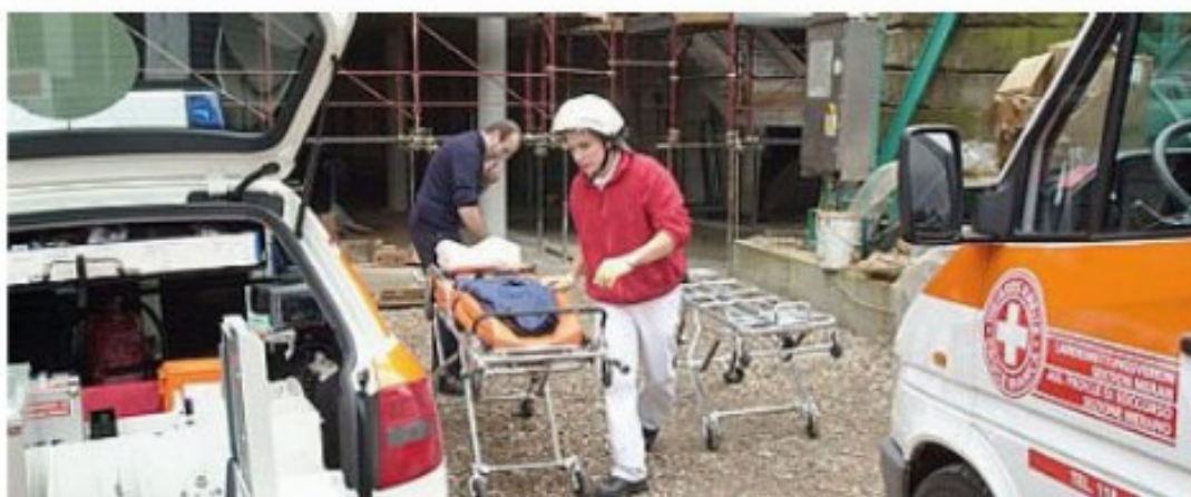
L'incidente si è verificato in un cantiere di Ora
