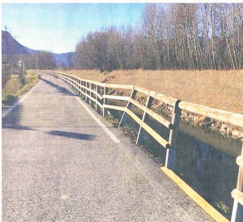
La ciclabile tra Ora ed Egna necessita di lavori urgenti
