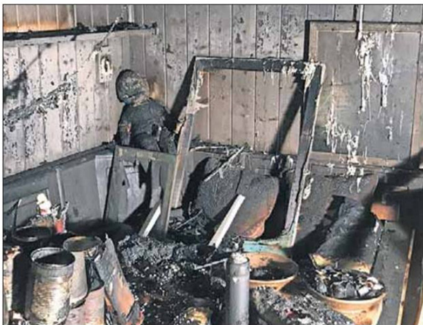
Der Schaden, der durch den Brand verursacht wurde, ist beachtlich.
