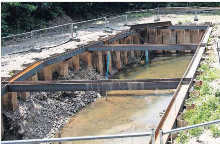
Bei Grabungsarbeiten für eine Abwasserleitung ist die Fliegerbombe in etwa 4 Metern Tiefe entdeckt worden. DLife/RM
