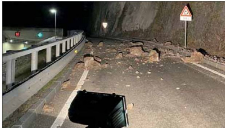
Kurz vor 3 Uhr morgens ist die Feuerwehr Auer gestern zu einem Steinerschlag im Bereich der Umfahrungsstraße ausgerückt. FFW Auer
