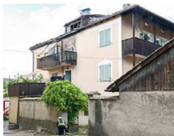
• Il balcone danneggiato su un lato dello stabile
