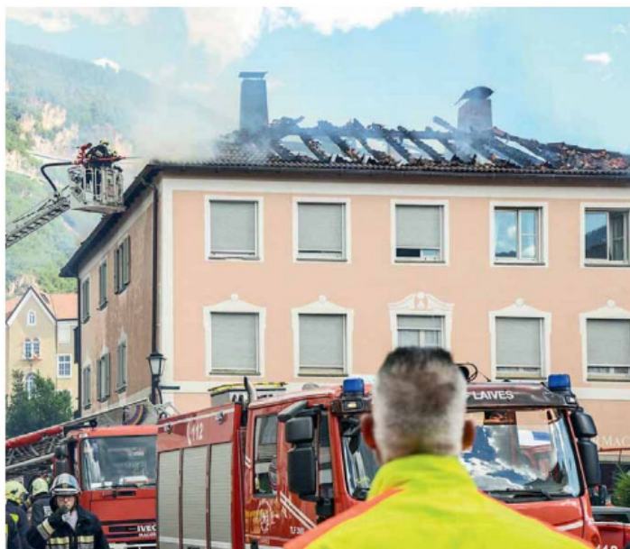
• Le fiamme hanno divorato il sottotetto: ne è rimasto lo scheletro (fotoservizio Daniele Fiorentino)
