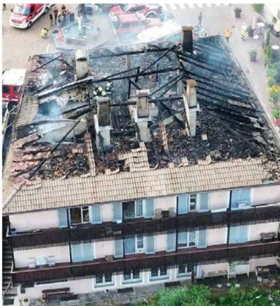
• Il tetto dell'edificio distrutto dall'incendio (foto vvf Ora)
