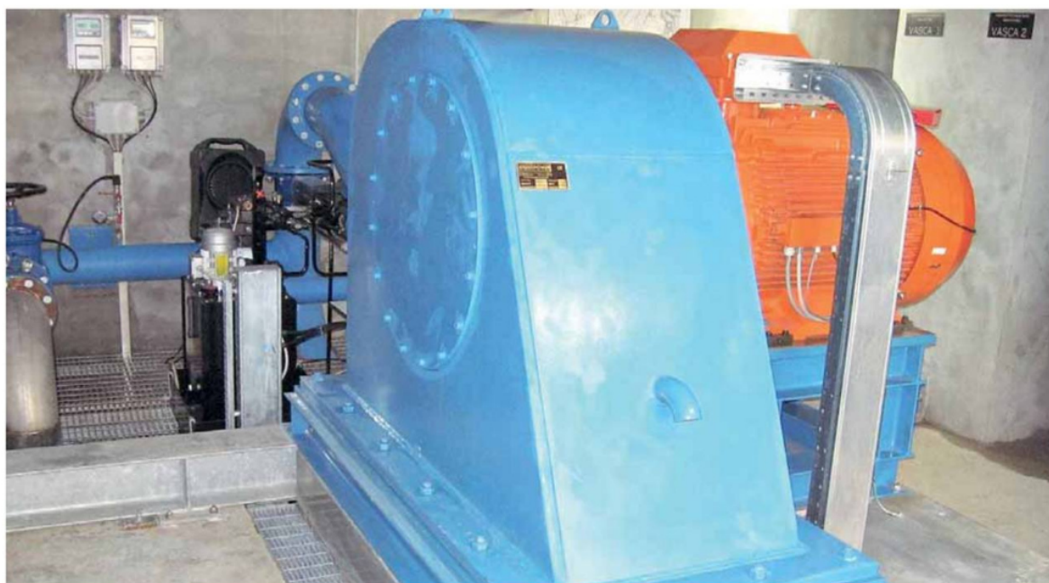
• Una centralina idroelettrica: il Comune di Ora intende realizzarne una sul proprio acquedotto
